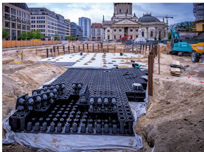
Abb. 4: Schwammstadtumbau am Gendarmenmarkt: Rigolen versickern Regenwasser (Foto: Berliner Wasserbetriebe/Sven Bock)
