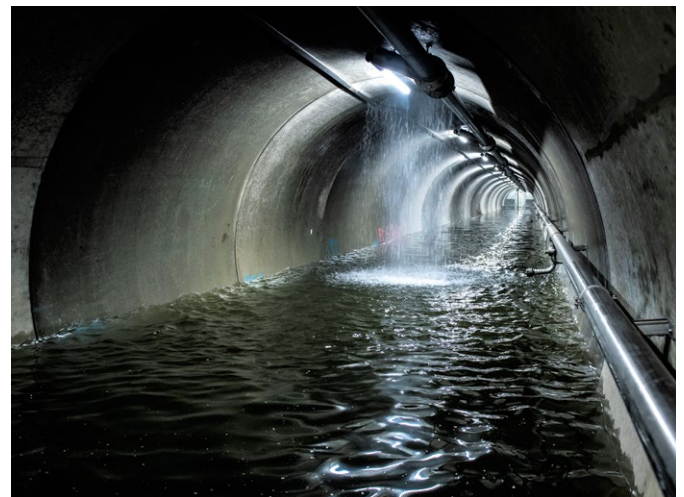
Abb. 3: 654 Meter lang unter dem Mauerpark: Stauraumkanal – Parkplatz für fast 7000 Kubikmeter Abwasser bei Starkregen (Foto: Berliner Wasserbetriebe/Benjamin Pritzkuweit)
